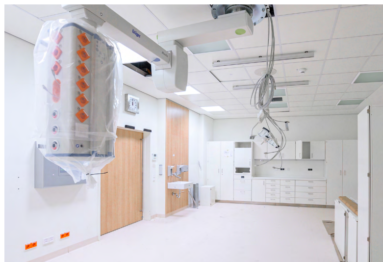
In der Radiologie und vielen weiteren Fachbereichen werden bereits medizinische Geräte installiert.
