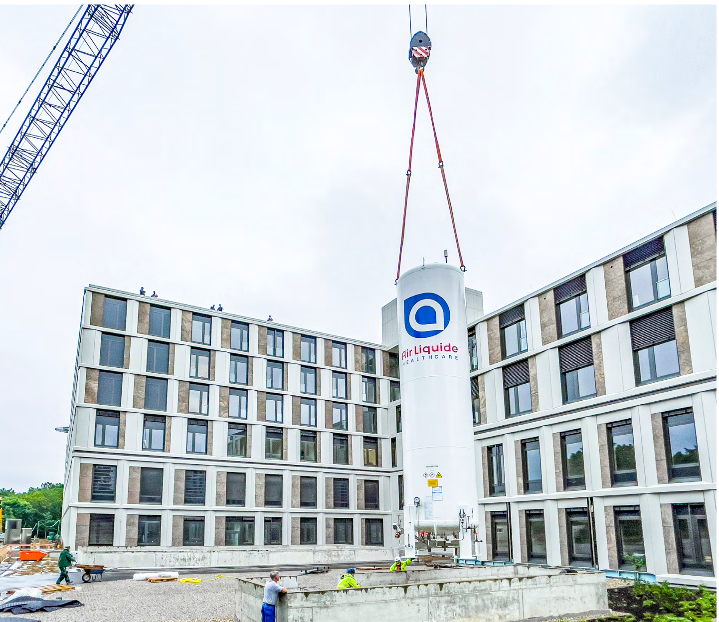
Im Juni erhielt der Klinikneubau in der Steinhäuserstraße einen eindrucksvoll großen Tank mit Flüssigsauerstoff zur Versorgung der künftigen Patienten. Der Tank hat ein Fassungsvermögen von 22.000 Litern, ist 9,43 Meter hoch und hat einen Durchmesser von 2,20 Metern. Zur Einbringung war ein 500-Tonnen-Kran mit 85-Meter-Ausleger erforderlich, der mit sechs Sattelschleppern und einem 80-Tonnen-Hilfskran angeliefert und aufgebaut wurde.
