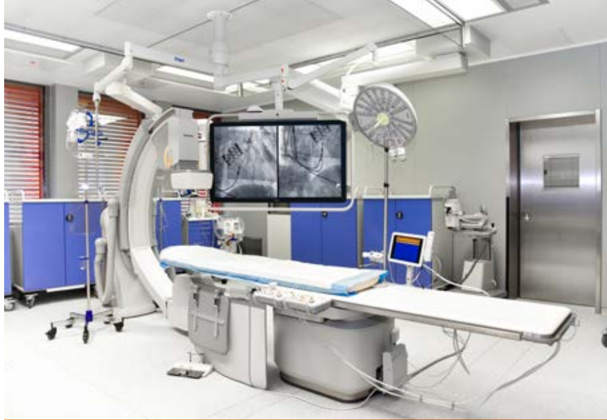
Die neue Herzkatheter-Anlage in der Südendstraße.
